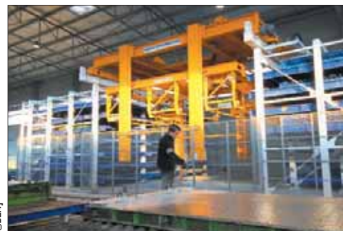
L'étuve et son ascenseur offre une capacité de stockage de 42 plateaux. Pour le moment, elle n'est pas encore bardée pour vérifier le bon fonctionnement de cet ensemble.
