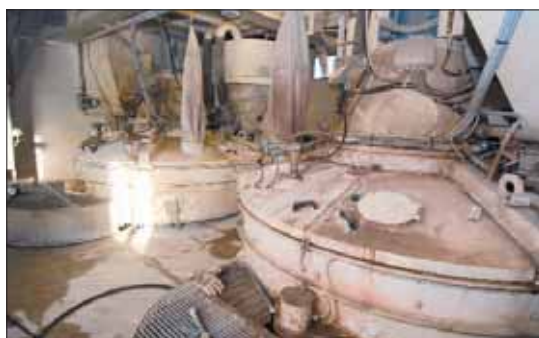
Deux malaxeurs à trains valseurs Rocchio à deux sorties constituent les outils de la fabrication des bétons.
