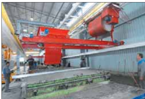
Télé-benne basculante à cuve fermée et trémie tampon de bétonnage. Ici, les dernières opérations de réglage durant la phase de mise en service de l'équipement.
